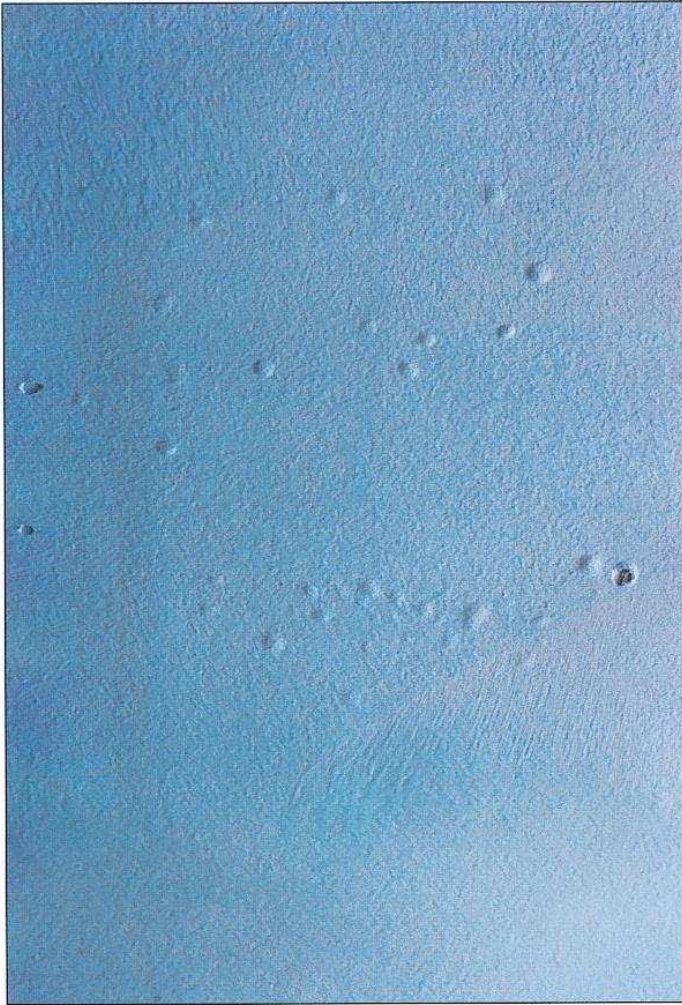
Photo 1-1 : le cas classique : petites bulles bien rondes sous la surface du gelcoat
