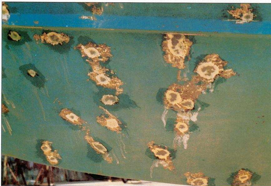
Photo 2-14 : traitement localisé aux cloques seules. Il faudra recommencer dans peu de temps
