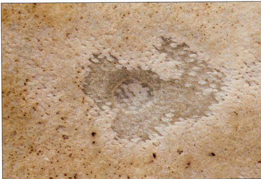
Photo 2-32 : dégradation des premiers mats, du roving suivant, des mats suivants et enfin du 2ème roving. Profondeur du cratère : 9 mm
