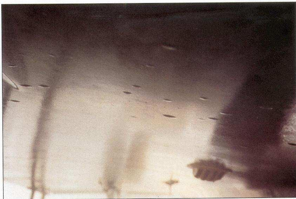
Photo 2-36 : très nombreuses très grosses cloques vues en lumière rasante
