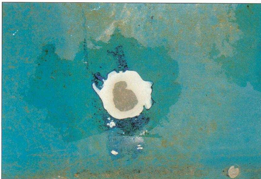
Photo 2-15 : traitement localisé aux cloques seules. Il faudra recommencer dans peu de temps
