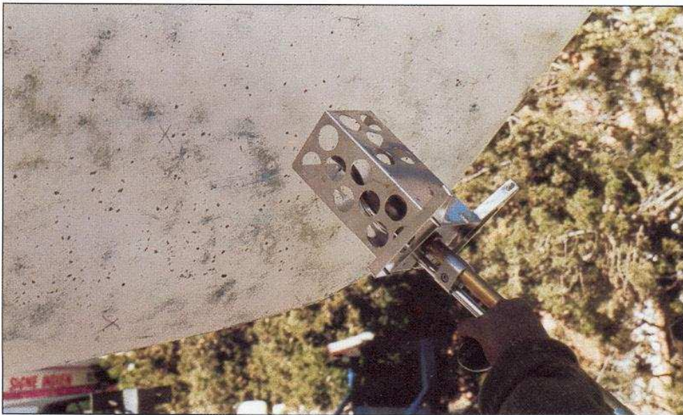
Photo 2-19 : chalumeau à air comprimé "HYAB"
