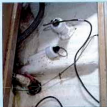
Oxydée, la vanne des W.-C. est à remplacer. A côté, les capteurs sont en bon état.
