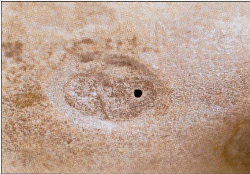
Photo 2-46 : le sablage a percé le stratifié
