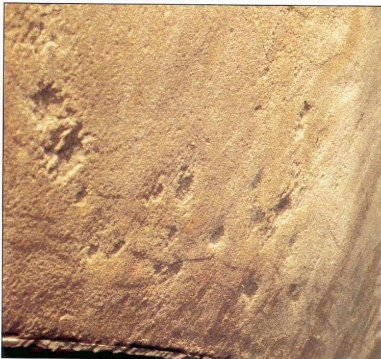
Photo 2-24 : cratères après sablage
