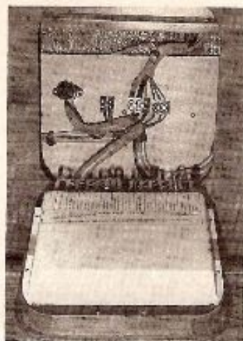
Tous les circuits électriques sont repérés sur les nouveaux tableaux.
